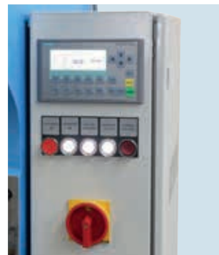
Steuerschrank Control cabinet
